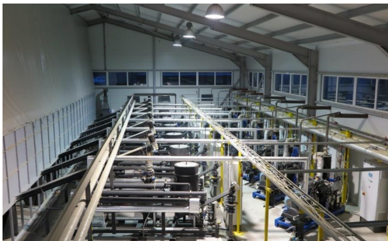
Ilustración 8: Instalación de Cogeneración en Cascada en Aserradero - Spanner Re2 GmbH [2].
